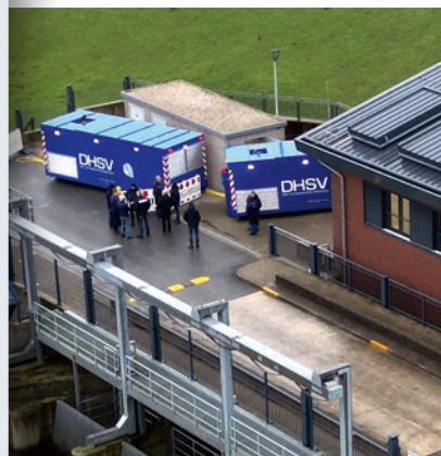
Probetrieb der mobilen Notstromaggregate am Schöpfwerk Steertloch, 2023
