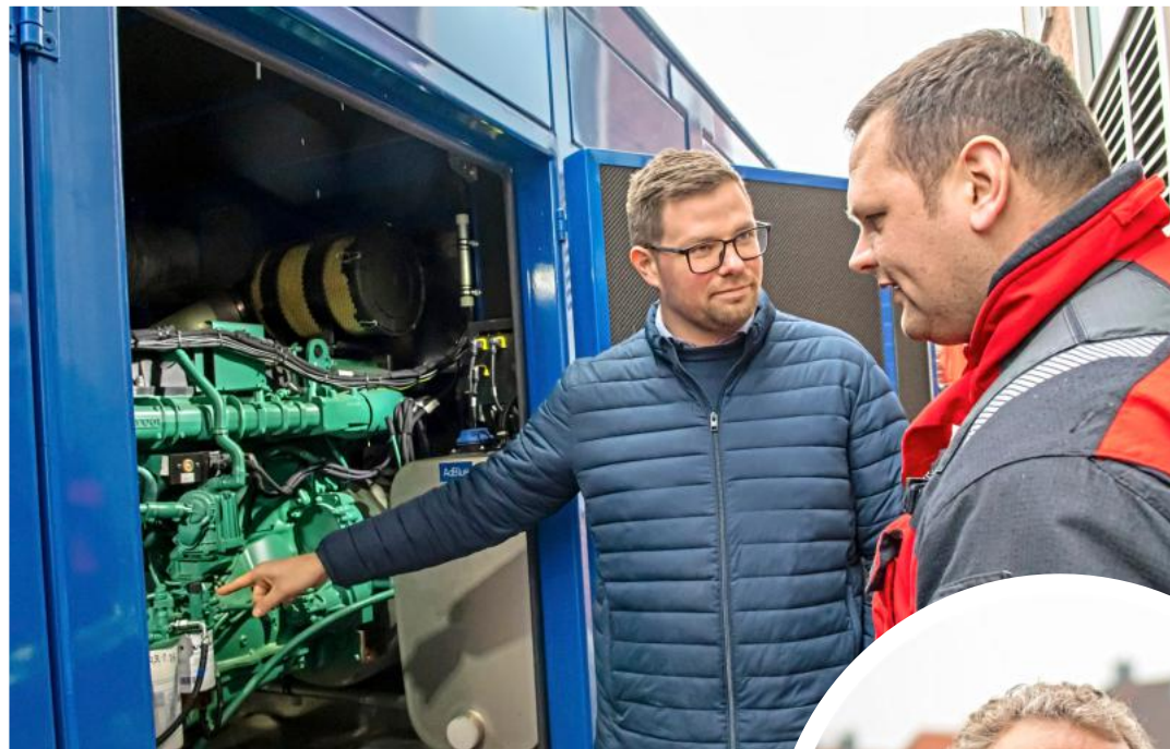
Thomas Faller (links) unter anderem bei der Stadt Brunsbüttel für den Zivilschutz zuständig und Benjamin Bornemann, Gerätewart der Freiwilligen Feuerwehr Brunsbüttel, begutachten das Notstromaggregat des DHSV. Die Stadt hat ebenfalls zwei Aggregate bestellt. Fotos: Turchetto
